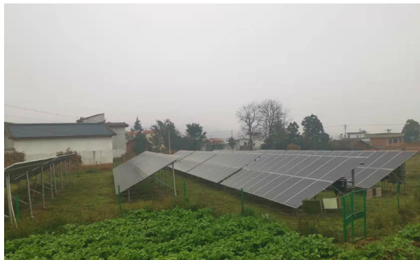
公司在云南省会泽县鲁基村发展光伏发电产业
