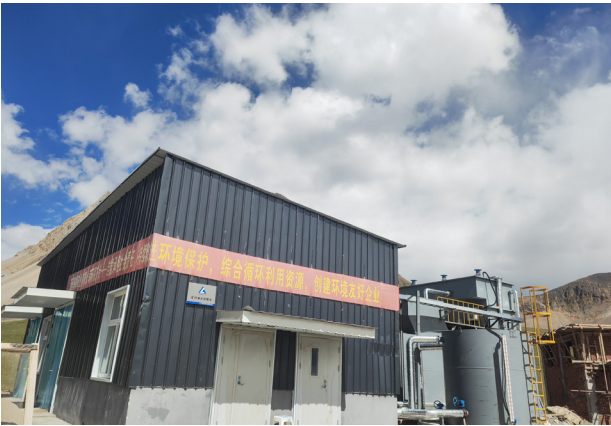
西藏鑫湖矿井涌水处理系统
