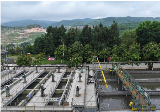
会泽矿业选矿废水调节池
