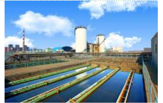
废水处理设施
