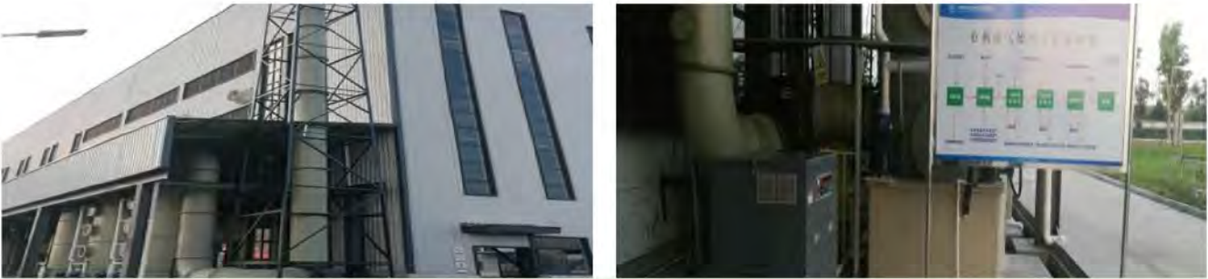
污水处理设施设备
