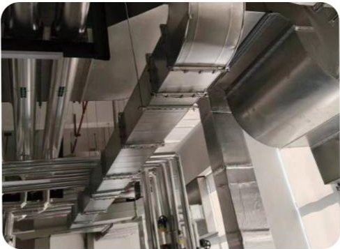
空调机组新风管路
