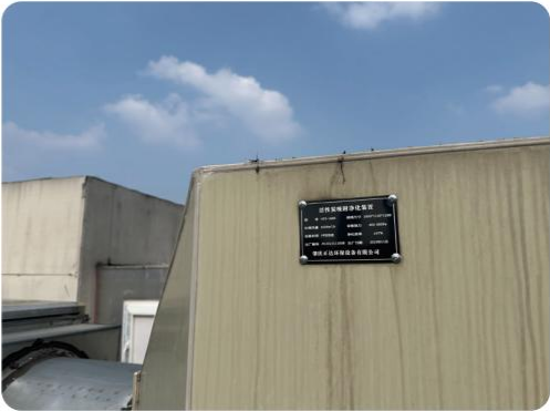
活性炭过滤装置
