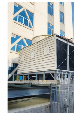
中央空调冷却水循环利用 3套中央空调、8个水塔
