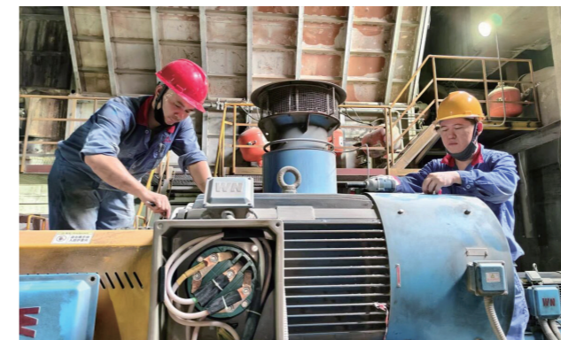
员工正在检查保养风机电机
