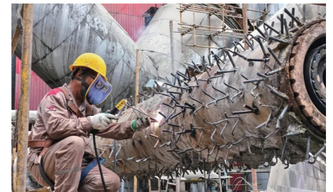
员工正在对设备进行检修
