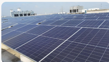
智能产业园屋顶光伏发电
