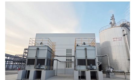
凝液回收冷却装置
