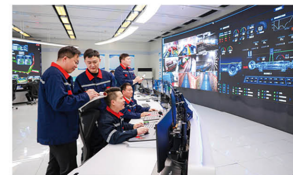
▲ 通过自动化控制系统远程操控井下设备
