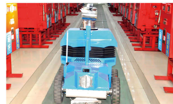
▲ 智能巡检机器人实现固定车间无人值守
