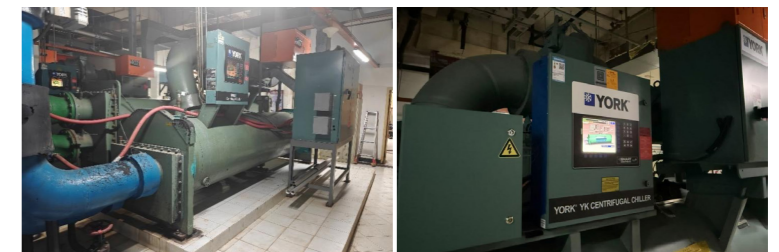
冷水机组改造前后
