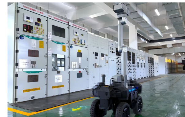
▶ 福建海上风电项目高清红外成像仪的轮式巡检机器人
