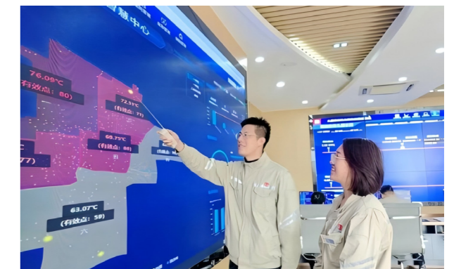
▶ 保定供热公司智慧供热云平台
