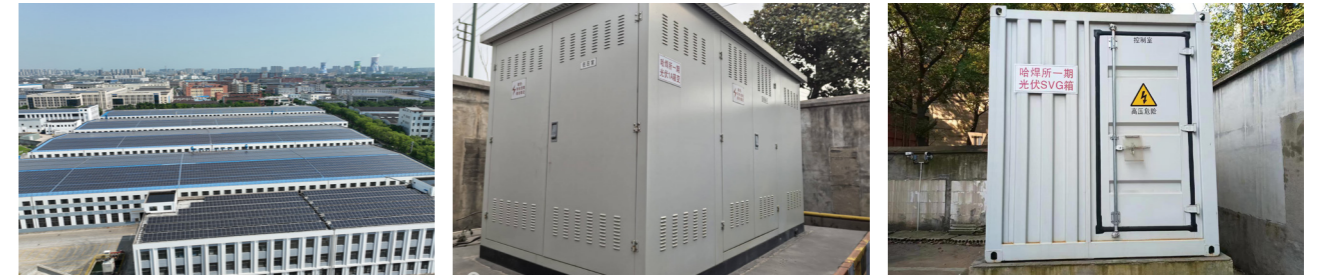
光伏发电照片
