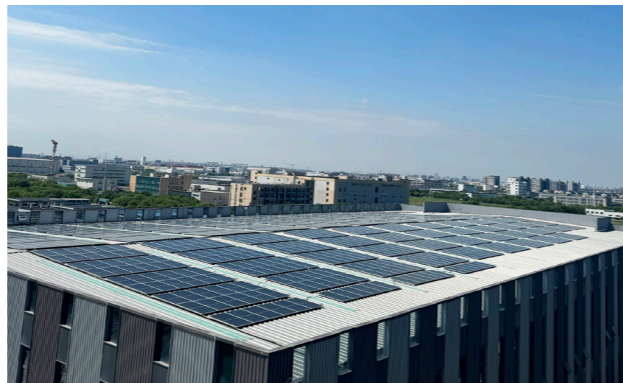
方大上海制造基地光伏屋面
