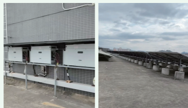
韶关朗科屋顶光伏 ▶
