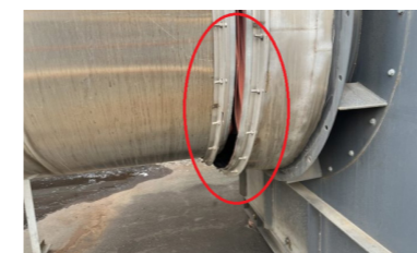
管道软连接开裂
