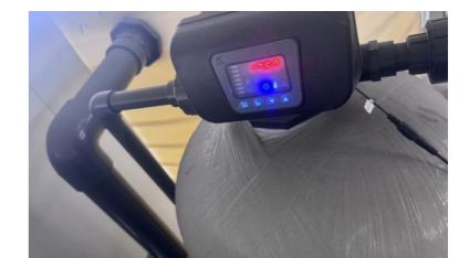
污水处理砂滤正常运行后
