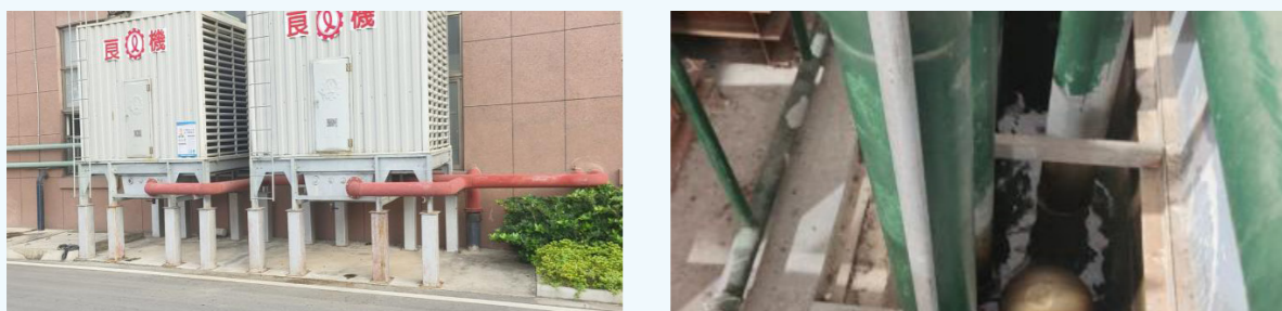
设备冷却水循环利用设施
