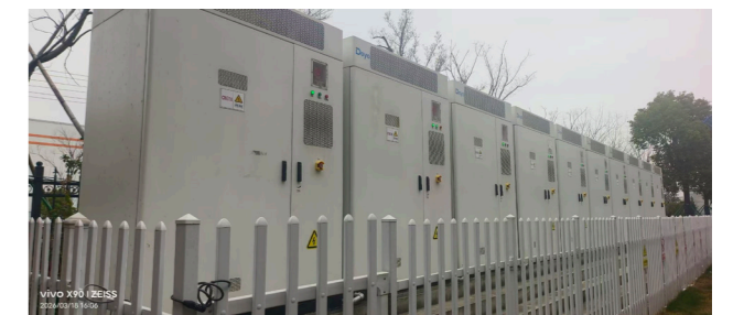
慈溪龙山 1MW 储能站
