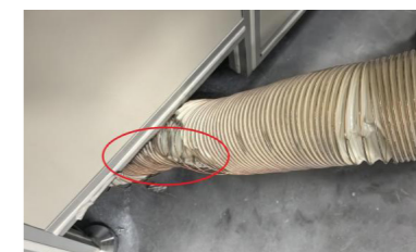
环保设施管道变形
