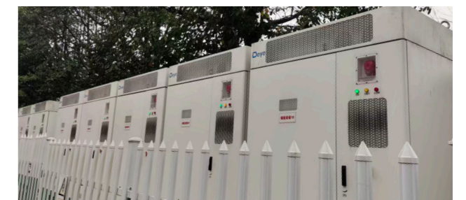
北仑总部 1MW 储能站
