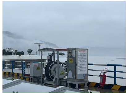
江津港务岸电设施
