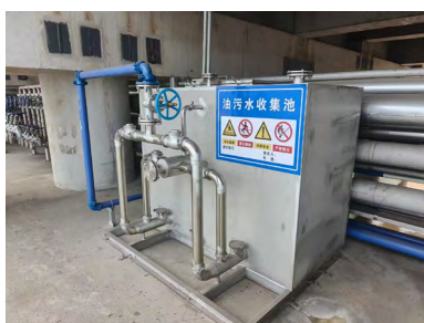
江津港务油污水收集池
