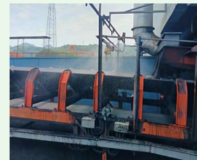
皮带机湿式除尘系统
