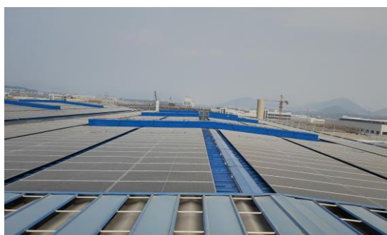
安徽永茂泰厂房屋顶光伏
