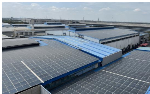
上海永茂泰厂房屋顶光伏
