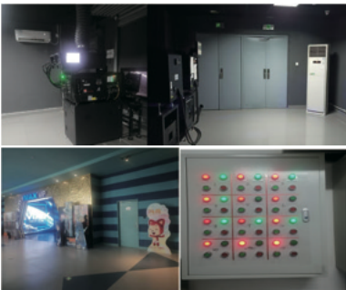
空调集中控制室位置
