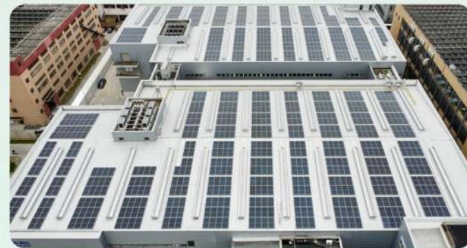
新厂650KW屋顶光伏项目
