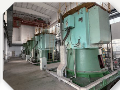
海水循环泵房
