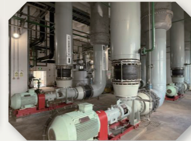
脱硫废水处理系统
