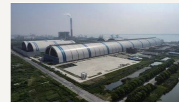
干煤棚屋顶空间光伏板布设
