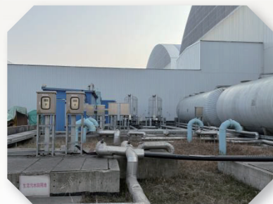
生活污水处理系统
