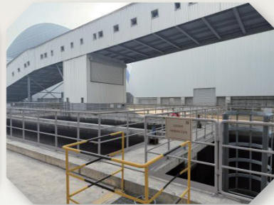
含煤废水处理系统
