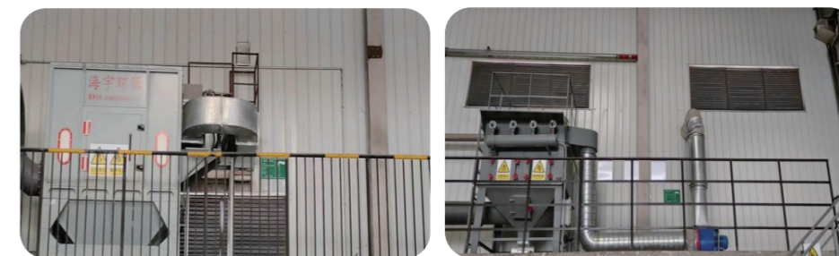
废气治理设施 ▶
