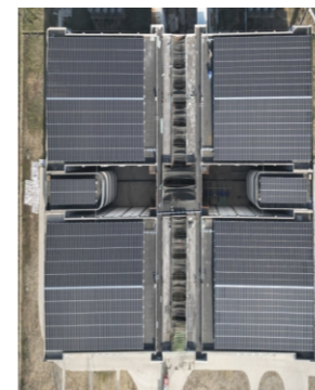
常州年华遥观楼房养猪场光伏项目
