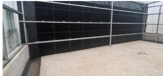
网格填料/填料球除臭间
