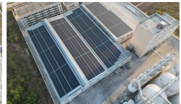
南雄饲料厂光伏项目
