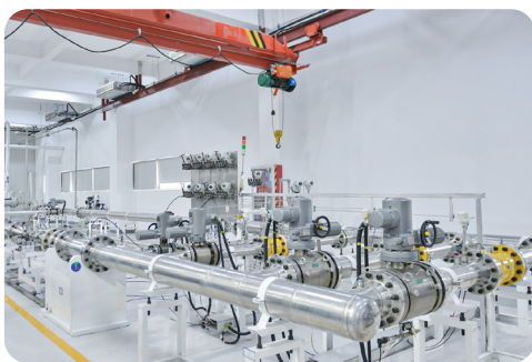
高压环道鉴定装置
