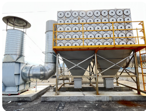
电焊废气处理设施(新)
