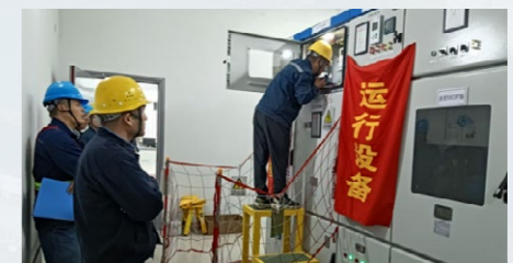
35KV变电站光伏变成功通电
