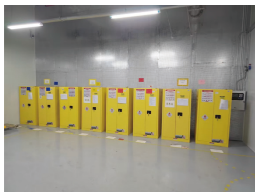
危险化学品存放 (车间内)
