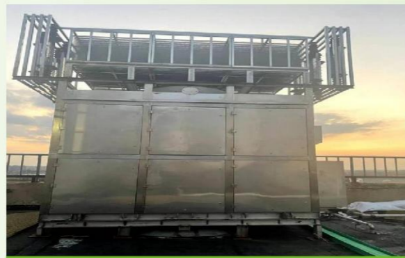
排放口安装排气筒等离子除尘器降尘
