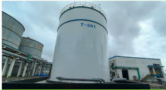
盐钙储水池降氨减少氨无组织排放项目
