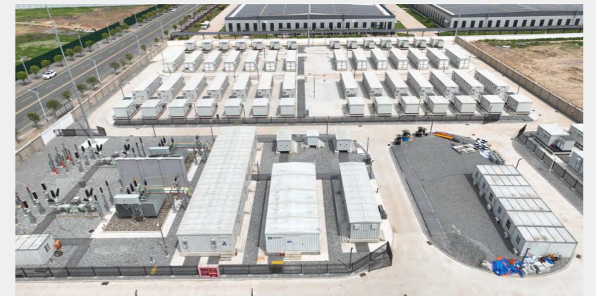
光山县 100MW/200MWh 独立共享储能电站项目
