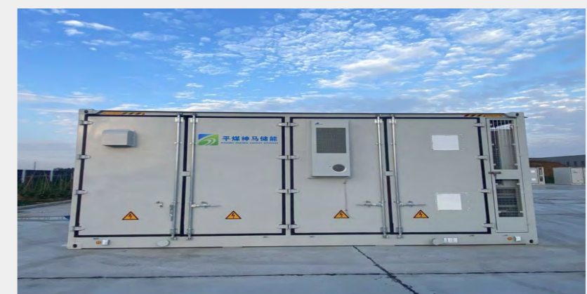
天安煤业九矿主通风机应急电源配储项目
