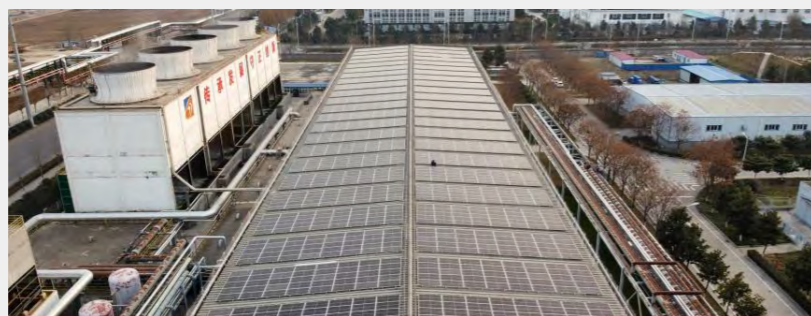
11.3MW 光伏屋顶项目
