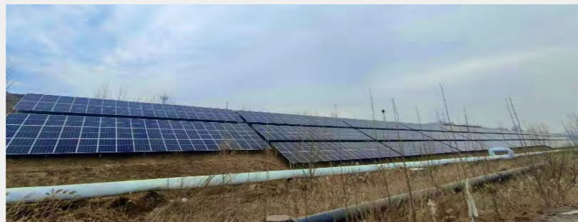
铁路沿线护坡 3MW 光伏项目
