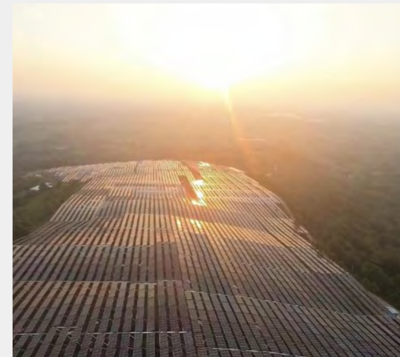
郑县堂街 25MW “牧光互补”项目（一期）
