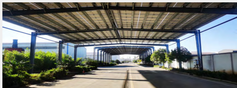
19.4MW 光伏大道
