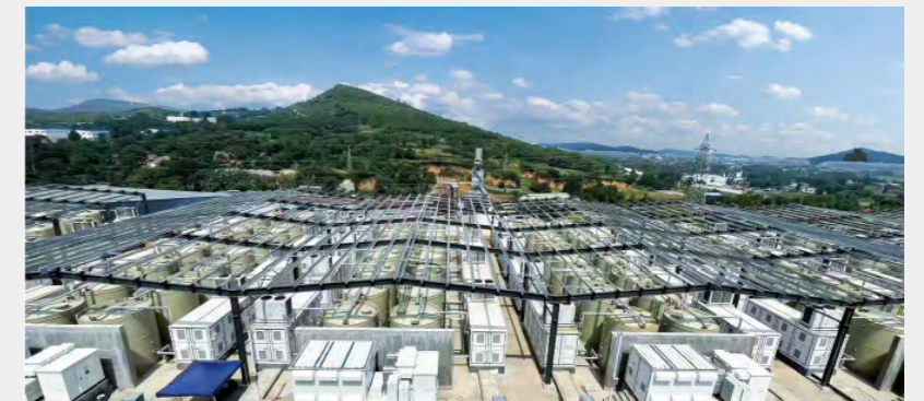
24MW/96MWh 全钒液流储能项目
