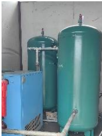
正风厂区 3 个储气罐 + 管道
