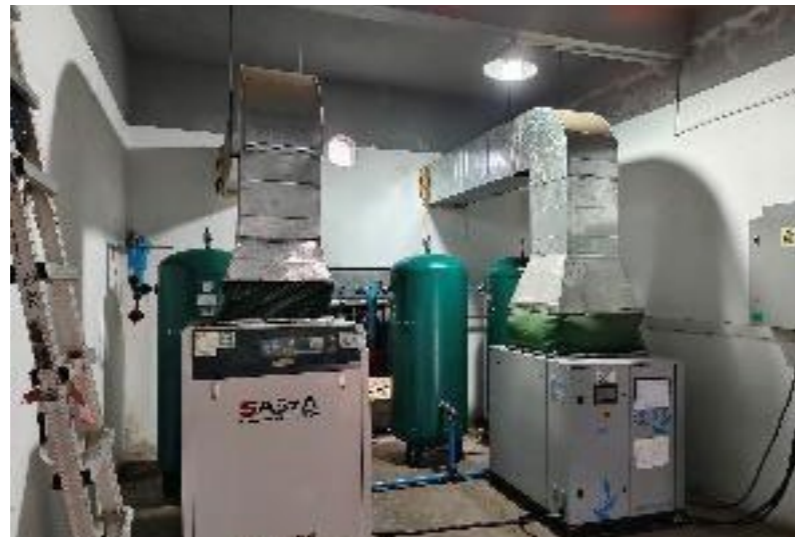
建实厂区 3 个储气罐
