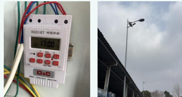
充电区时控开关 太阳能照明灯
