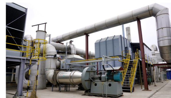
RTO 废气治理设施
