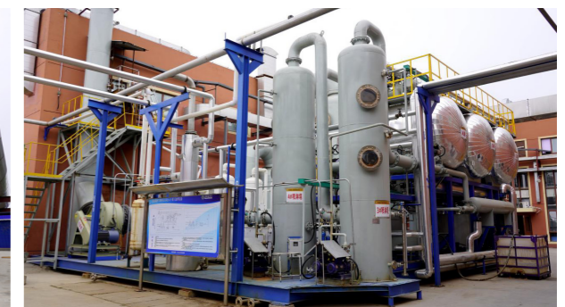
尚博医药三车间树脂吸附废气治理设施
