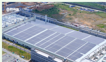
公司屋顶光伏发电装置
