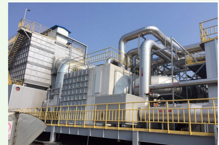
废气处理设施
