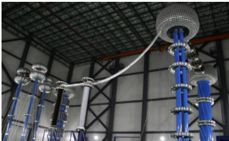
亨通超高压电力测试技术中心
