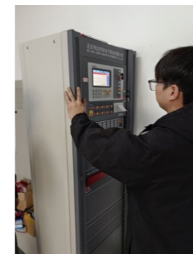
消防设备监控主机
