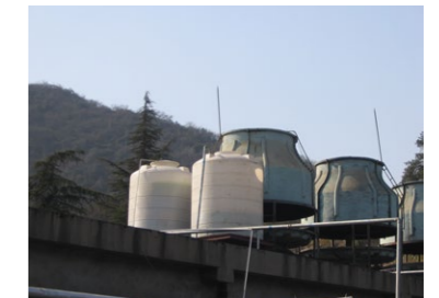
再生水资源高位储水箱
