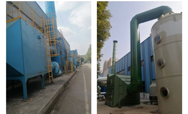
废气处理设施
