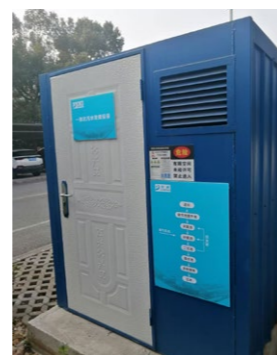
废水处理设施
