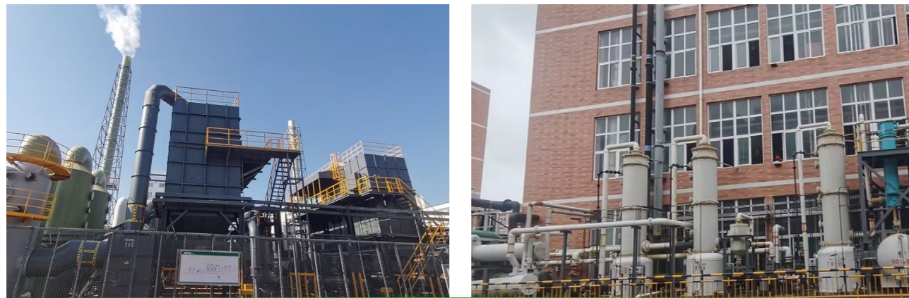
废气处理设施
