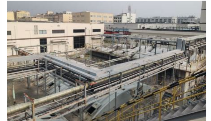
废水处理设施
