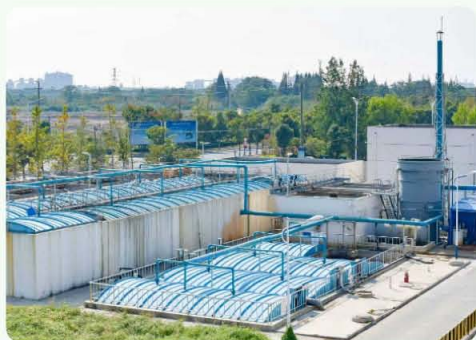
海阳锦纶污水处理设施
