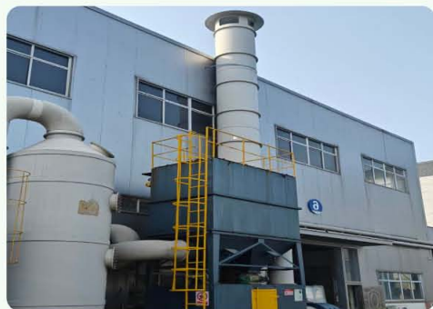
华恒新材料配套喷淋吸附废气处理装置
