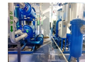
导入空压机余热回收装置
