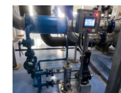
冰水主机安装在线自动清洗装置
