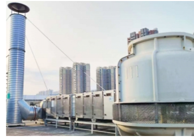
双级活性炭废气处理设施
