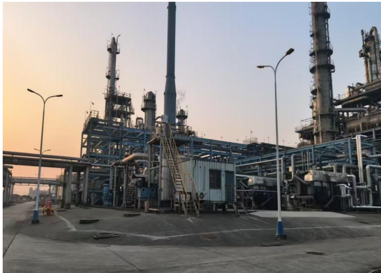
图：江苏奥克设有废热锅炉焚烧装置 1 套，用于处理乙烯回收单元尾气等废气
