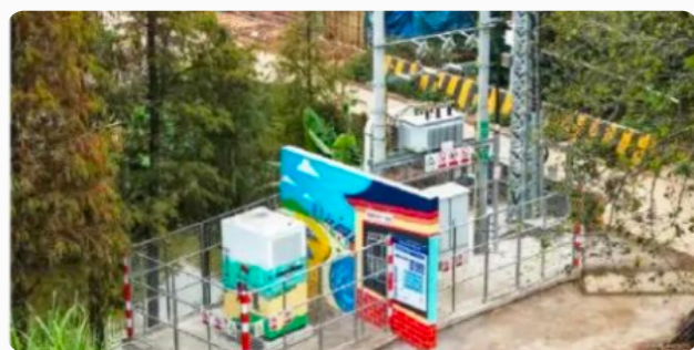
佛山，首个台区储能系统在海寿岛项目正式并网投运
