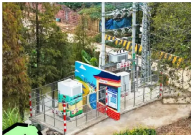
广东省海寿岛多元微电网项目
