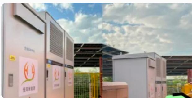
广州，南沙龙穴岛光储一体离网项目投运，实现储能赋能海岛及备电民生
