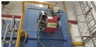
热洁炉二次燃烧机减少氮氧化物排放
