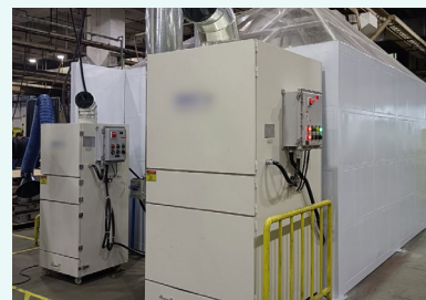
焊接烟尘处理系统
