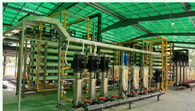
工业废水处理站回用系统
