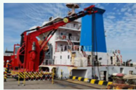
兴华港口岸电设施
