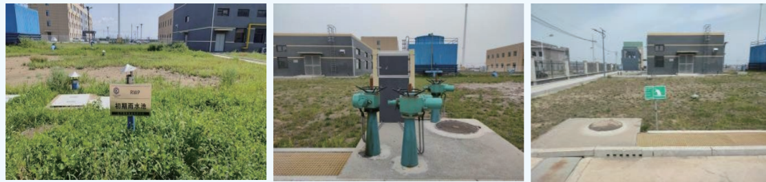
● 雨水收集池、截断阀和排口 (辽宁基地)
