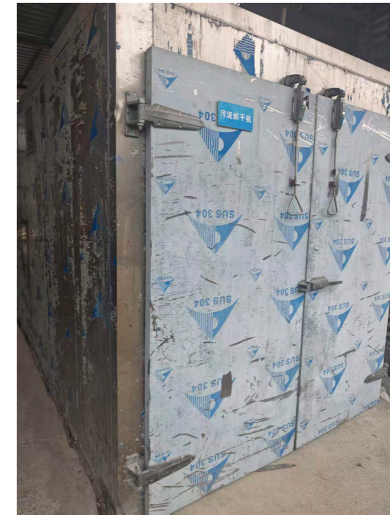
新增污泥干化设备
