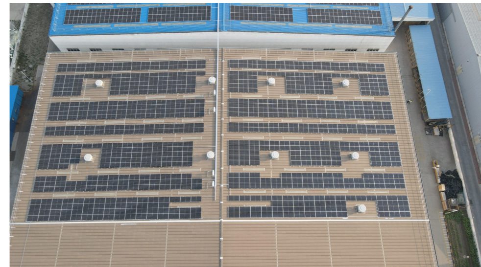
天津科技分布式光伏发电项目
