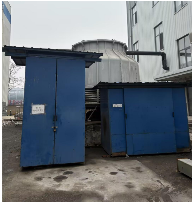
天津科技水塔循环系统
