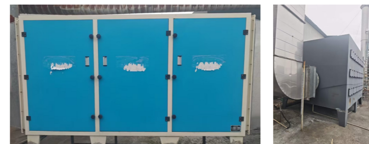
有机废气处理设施升级改造
