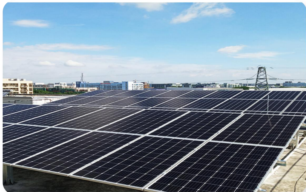
光伏实景 · 绿色生产示范基地
