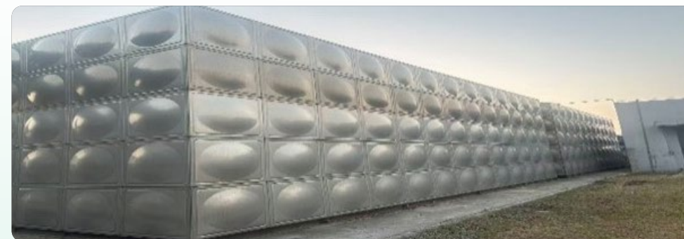
南通基地将冷凝水回收利用作为冷却水塔补水
