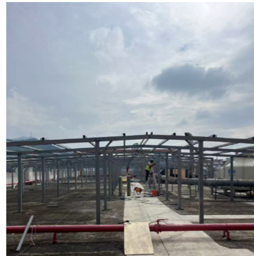
公司光伏装机设备
