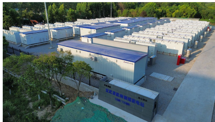
宝钢股份厂区内第一个储能项目
