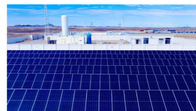
甘肃敦煌风光氢储试验场项目
