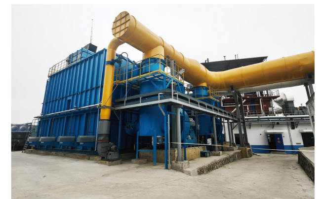
贵阳新田煤矿瓦斯发电余热全利用项目
