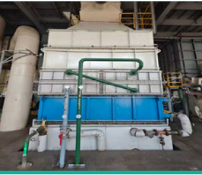
预处理车间调质塔
