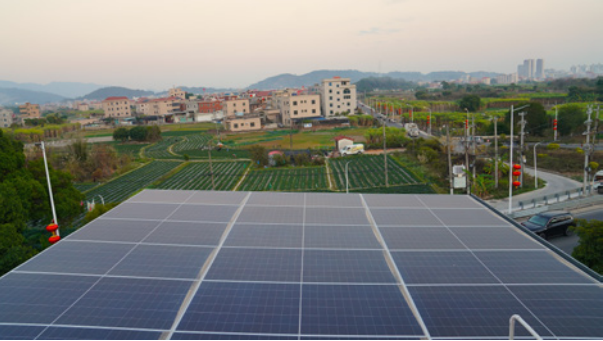
光伏板现场图
