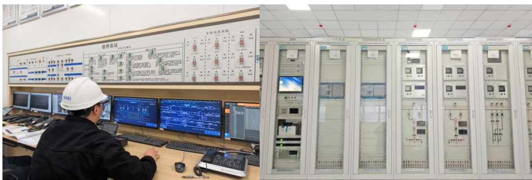
（宁马线综合监控系统同步投运）
