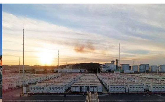
（沙特比沙 500 兆瓦/2 吉瓦时储能电站）
