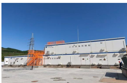
（马峡风电 10 万千瓦项目升压站）
